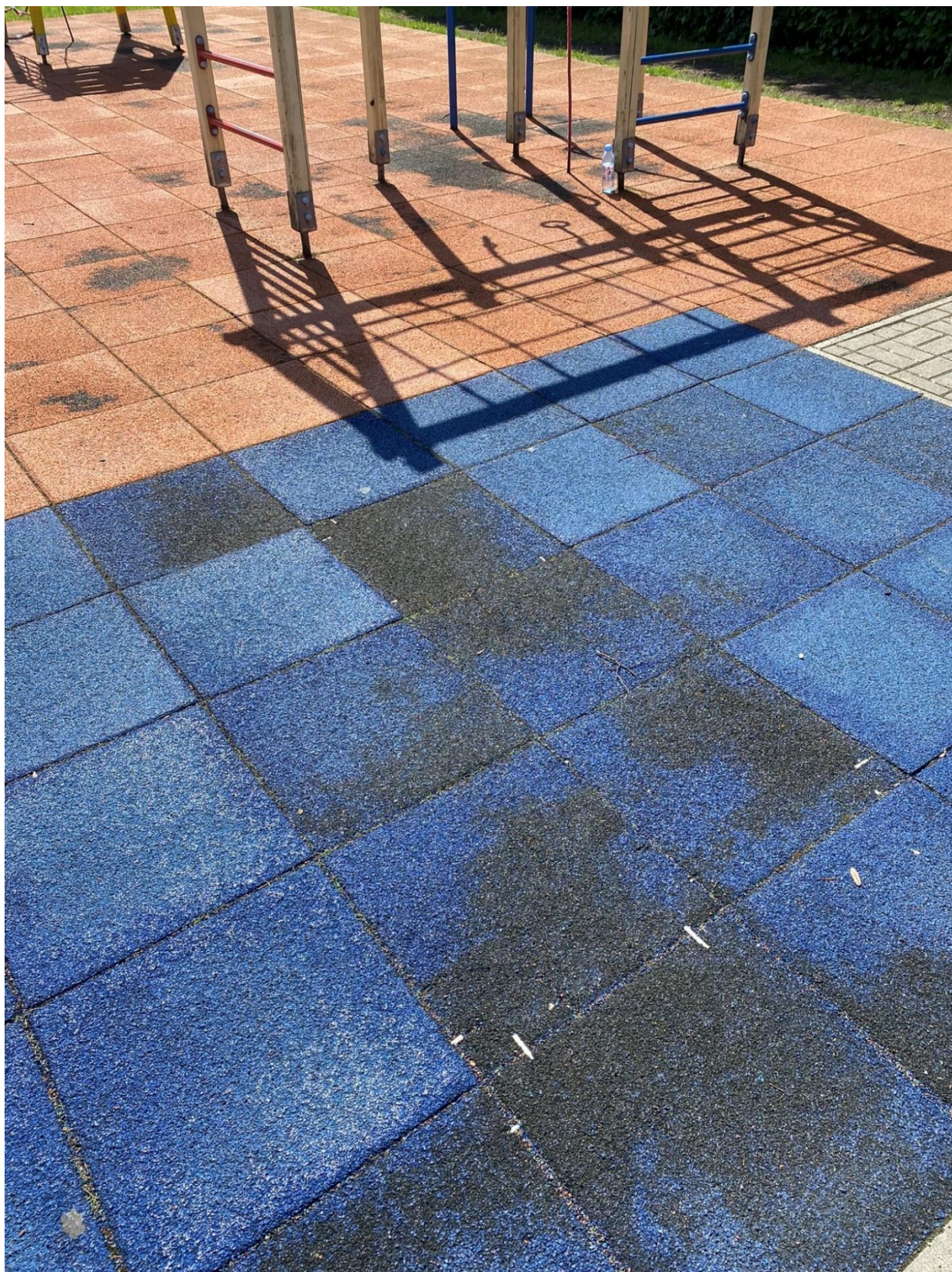
Zdj. 2- aktualna nawierzchnia placu zabaw (przetarcia i wystające elementy mocowania nawierzchni)
